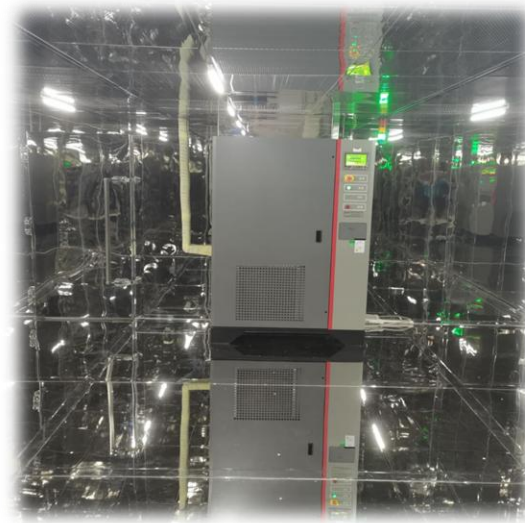
内置机组，冷冻机组置于舱内
